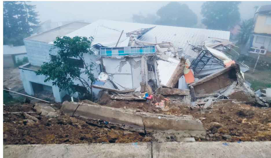
Los escombros de la vivienda afectaron el centro textil que construye Fonper.
